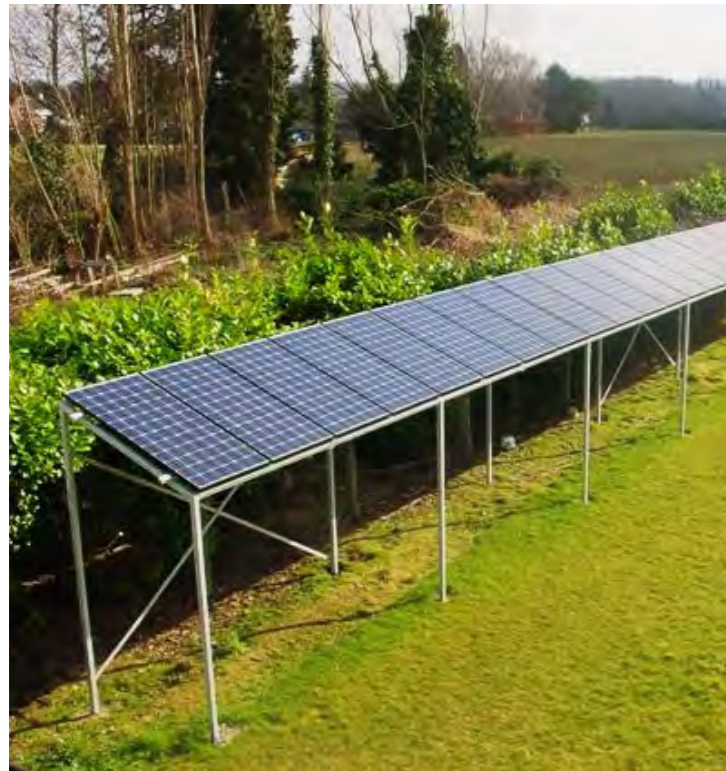
zonnepanelen langs de paden - bron: BDP.
